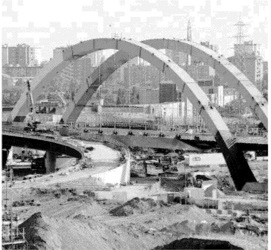
EXPO 2015 Uno dei cantieri sul sito dove si terrà Expo 2015 a Milano
